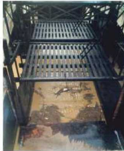
Fonctionnement en période de crue / Vue sur une bêche ouverte
