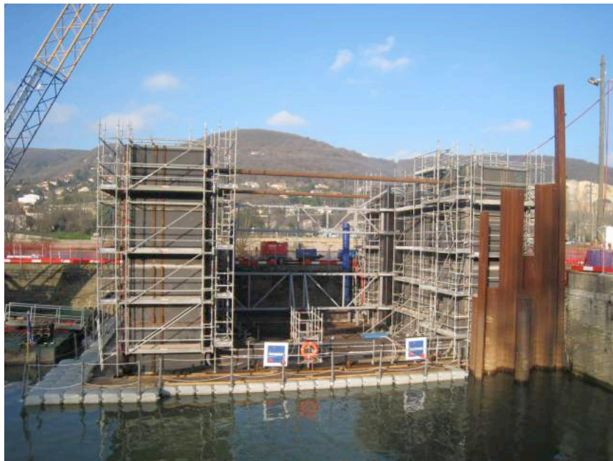
Assemblage des éléments du caisson (mise en place des bajoyers, ferrailage interne)
