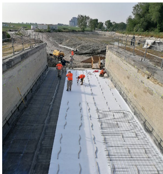
Pont canal de Noyelles-sur-Escaut : pose d'une protection géo synthétique sur la nouvelle étanchéité du radier du pont, avant mise en œuvre d'une chape de protection en béton armé (pose du ferrillage en cours)
