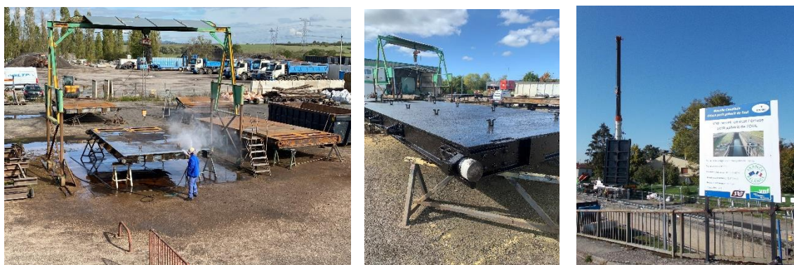
Réfection des portes en atelier (crédits photo : SRE SAS) et pose des portes rénovées
