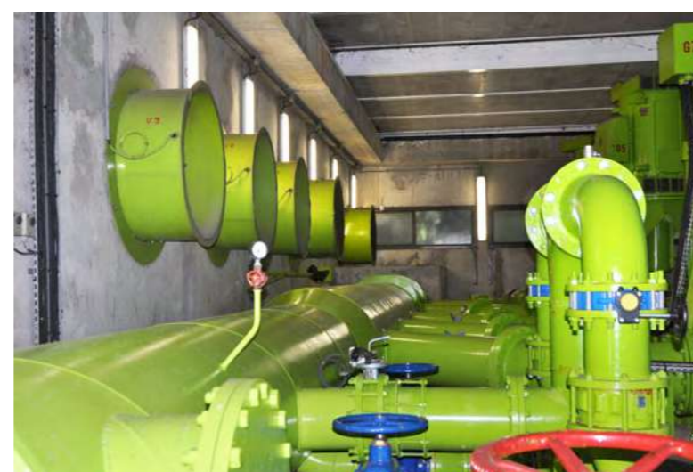
© BRL, Station de pompage à Naurouze
