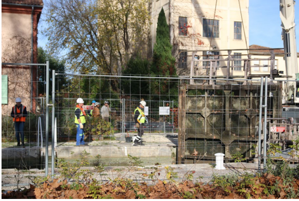
Levage de portes de l'écluse de Moissac pour changer les étanchéités bois ©VNF
